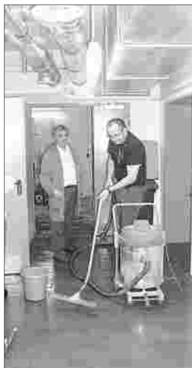
Die neuen Toiletten an der Zehnthofstraße mussten vom Wasser befreit werden. Foto: Lars Brepols
